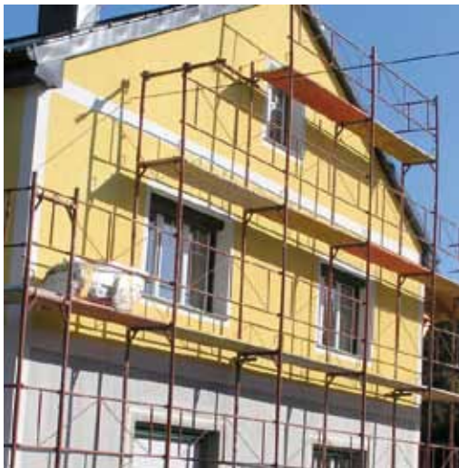
Außenwanddämmung reduziert Kesselleistung
