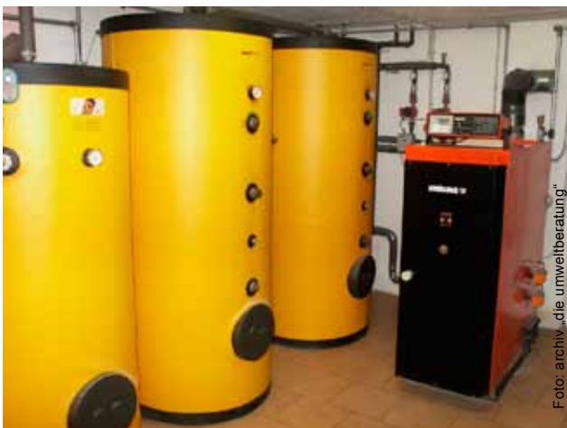
Holzvergaserkessel mit Pufferspeicher
